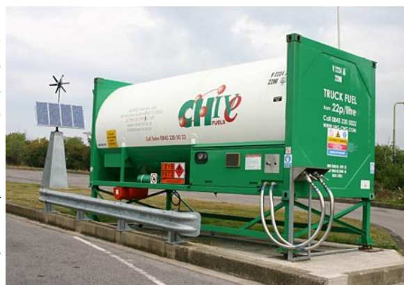
Serbatoio di GPL
