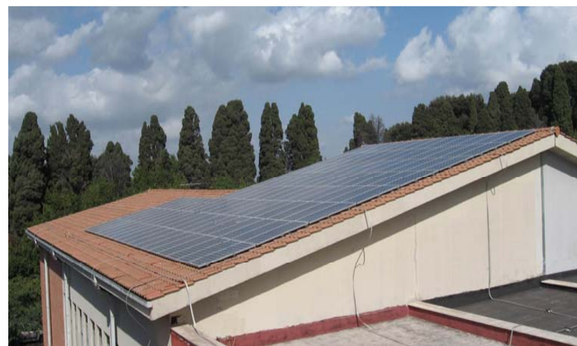
IL TETTO FOTOVOLTAICO DEL LICEO DI PALESTRINA
